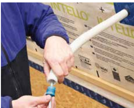
Заглушки STOPPA изолируют вывод кабеля из гофротруб.
